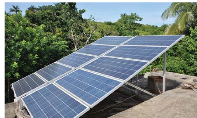
La utilización de paneles solares en la provincia se extiende al sector agrícola. /Foto: Vicente Brito
