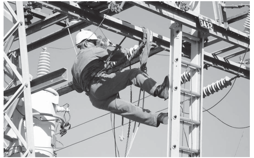
El nuevo transformador casi duplica la potencia del anterior. /Foto: Vicente Brito
