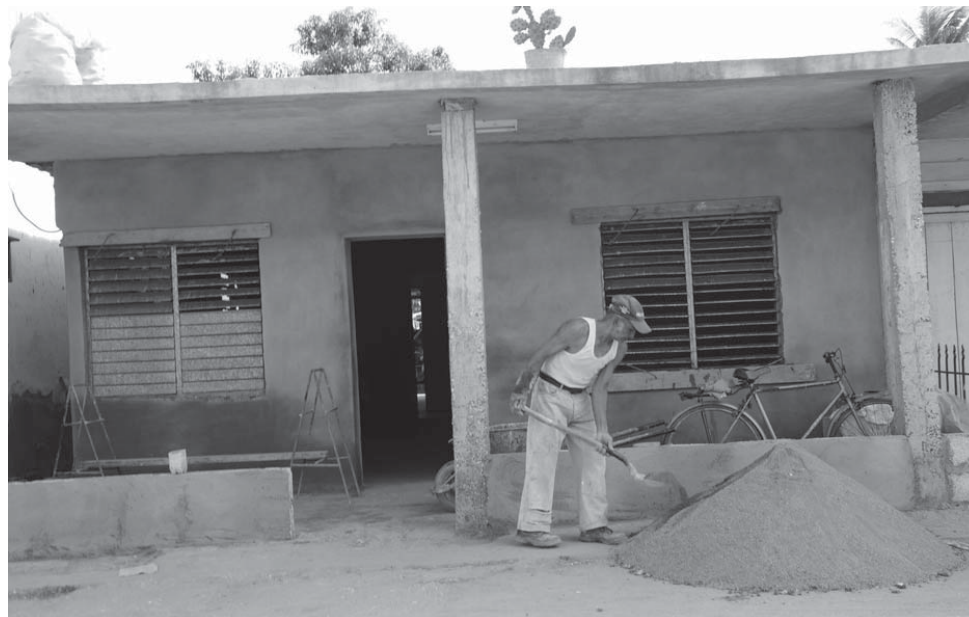
No siempre los subsidiados tienen a su alcance los materiales de terminación. /Fotos: Vicente Brito
