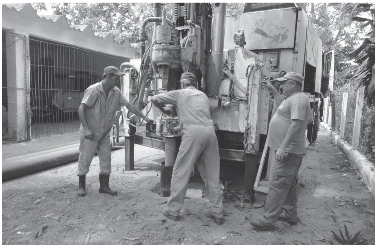
Tres hombres hacen el prodigio de perforar un pozo casi diariamente con una moderna máquina de avanzada tecnología.
