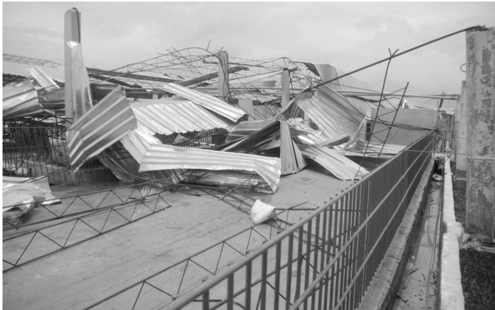
Como instalación individual Carbó II figura entre las más dañadas de la provincia. /Fotos: Oscar Alfonso
