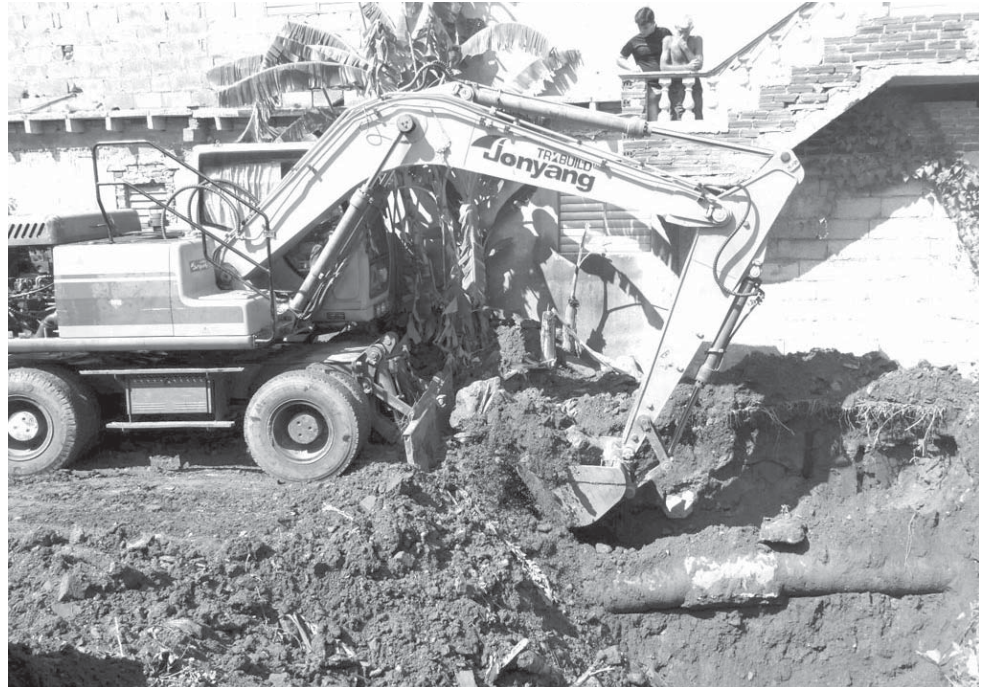
Fuerzas del territorio acometen la reparación de la conductora que abastece a Colón. /Foto: Reidel Gallo
