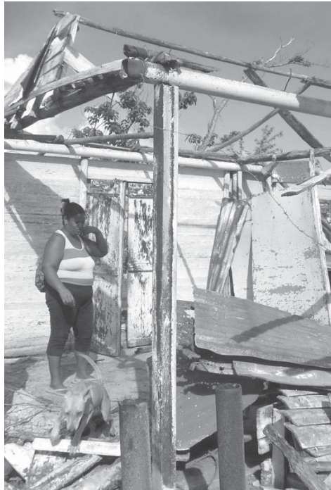
La vivienda de Iris Leidy es una de las afectadas en Aracelio Iglesias. /Foto: Gisselle Morales
