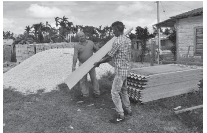
Con prontitud se asumió la entrega de materiales de la construcción a los damnificados en Venegas, pero algunos escasean.
