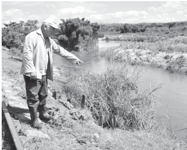
Conrado Peláez León, jefe de la brigada de Méyer, señala uno de los deslaves causados por el acercamiento del Agabama a la vía.
