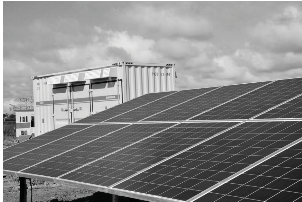
Con la explotación del Parque Solar fotovoltaico de Cabaiguán dejarán de emitirse en un año 5 603 toneladas de dióxido de carbono a la atmósfera. /Fotos: Vicente Brito
