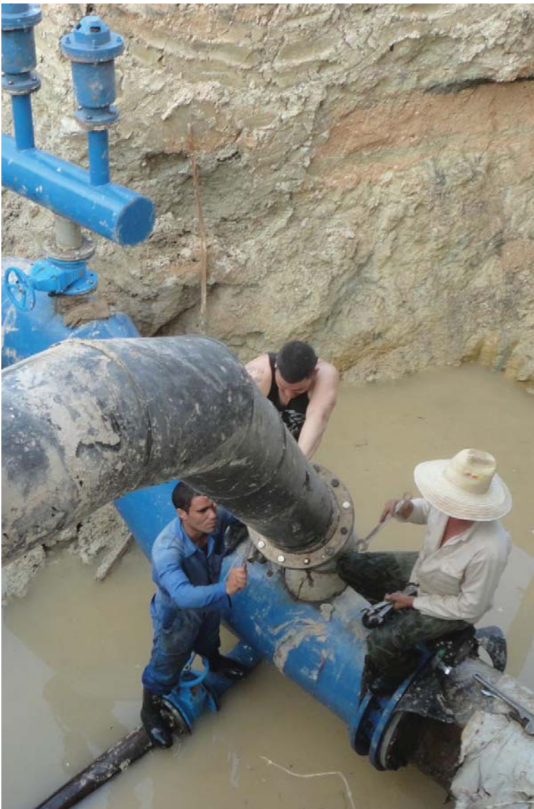
El acueducto beneficiará con agua potable a todos los vecinos de Jatibonico, incluidos sus barrios periféricos. /Foto: Luis Herrera
