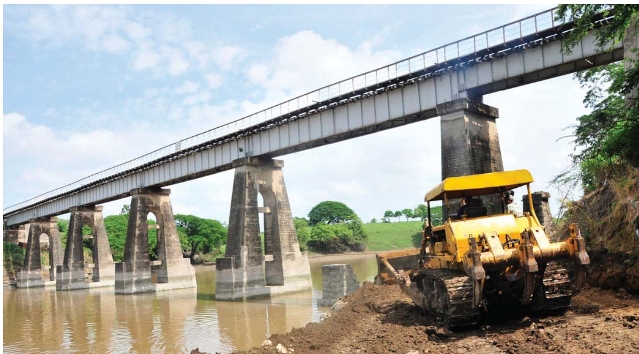
El acceso temporal de 150 metros permitirá llegar hasta la zona afectada del puente ferroviario. /Foto: Vicente Brito
