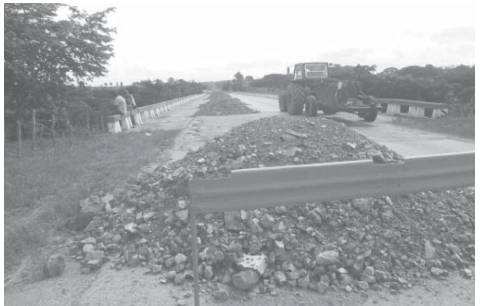
En el puente sobre la carretera de Yaguajay se cerró una senda como medida de prevención.
