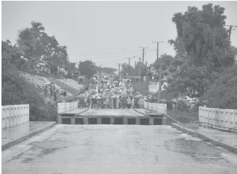
El puente de Zaza del Medio colapsó en la tarde del 28 de mayo último. /Foto: Vicente Brito
