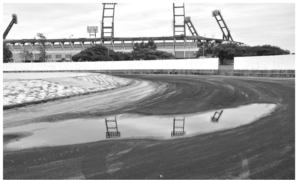
Las deficiencias constructivas de la instalación laceran la práctica de esta disciplina. /Foto: Vicente Brito
