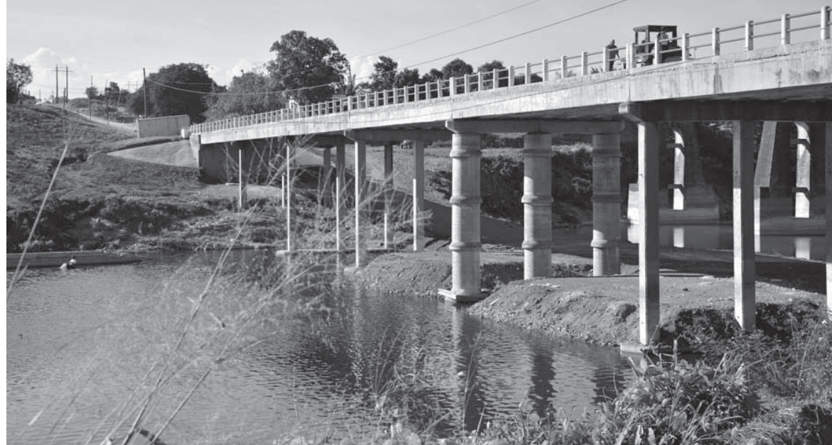
La reconstrucción del puente fue ejecutada en seis meses. /Fotos: Vicente Brito
