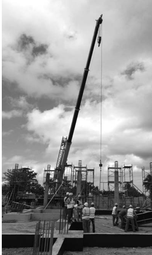
La Empresa de Construcción y Montaje ya trabaja en el hotel Meliá Trinidad Playa. /Foto: Cortesía de la AEI
