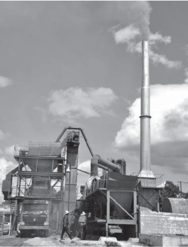
Tras una larga parada, la planta espirituaña produce intermitentemente por limitaciones de combustible. /Foto: Vicente Brito
