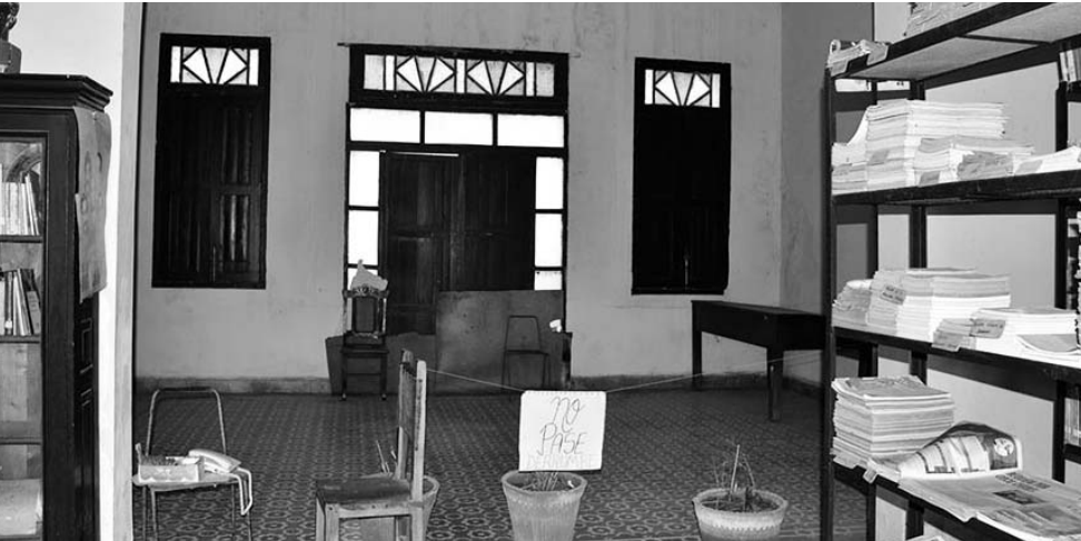
En el área que ocupaba las salas Infantil y Juvenil, Proceso y Computación un cartel advierte el peligro de derrumbe.
