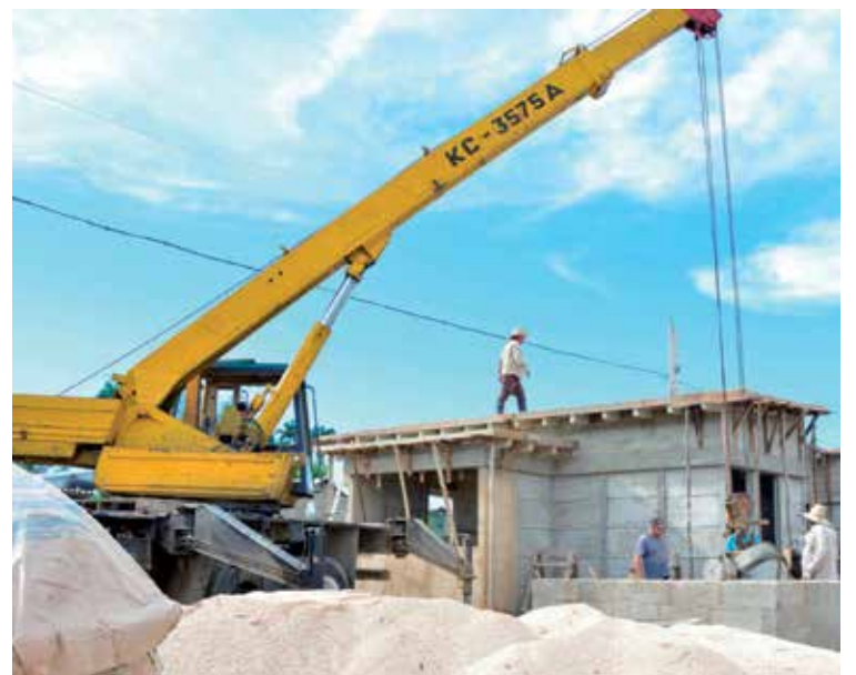
A pesar de la COVID-19, no se detiene la construcción de viviendas en el municipio de Yaguajay. /Foto: Vicente Brito
