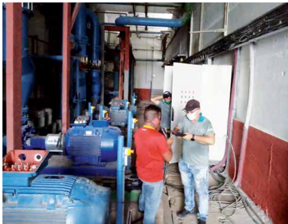
En la Planta Potabilizadora se ultiman detalles para conectar las bombas. Foto: Cortesía de Recursos Hidráulicos
