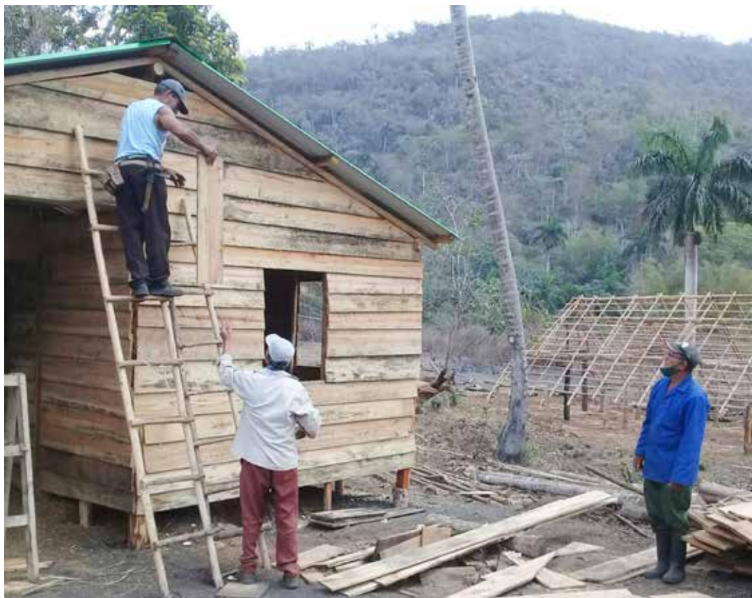
En una primera etapa se edifican 20 viviendas para asentar fuerza de trabajo en áreas de interés forestal y agropecuario.
