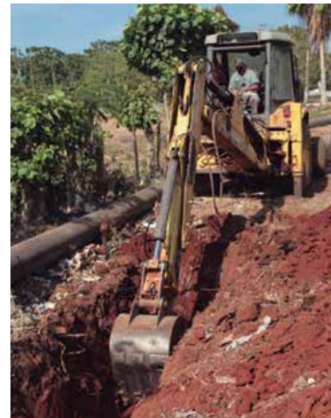
A pesar de las dificultades, los constructores laboran intensamente en la obra.
