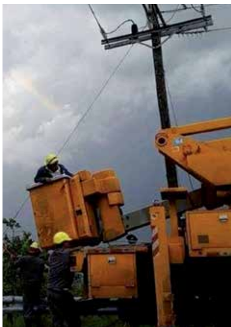
Las afectaciones eléctricas en Trinidad se solucionaron en breve plazo. /Foto: Juan Carlos Naranjo
