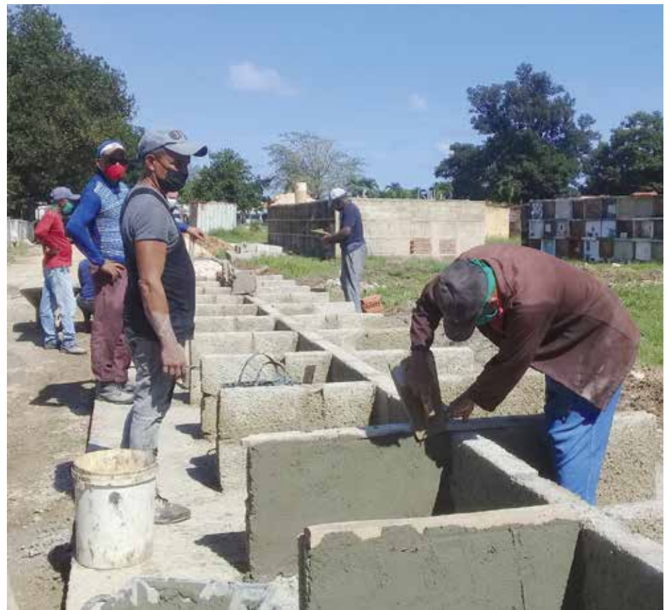
En el cementerio del Kilo-12 se construyen, desde el mes de mayo, nuevas capacidades para enterramientos; al menos 90 gavetas y 600 nichos estaban listos días atrás.
