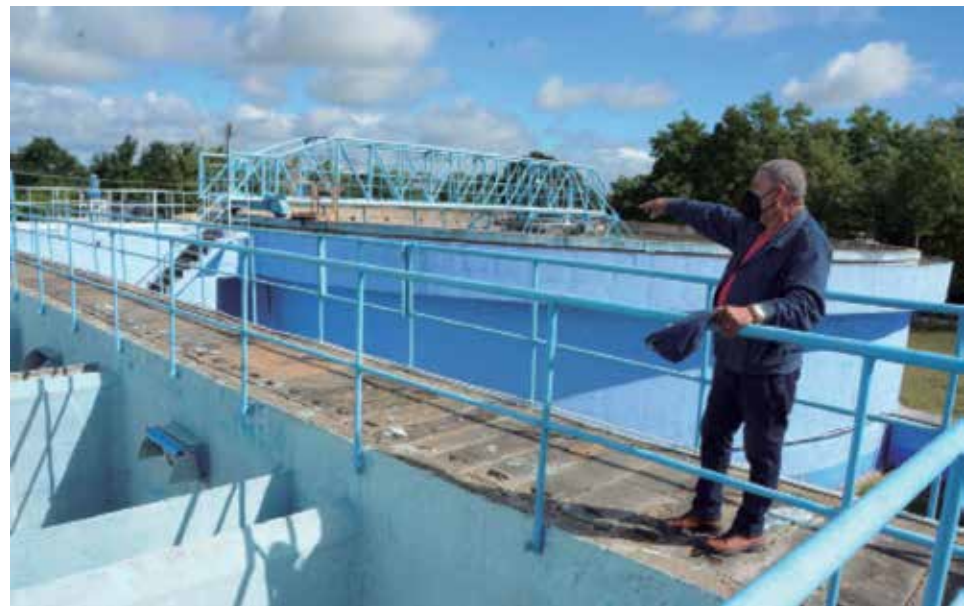
En la Planta Potabilizadora faltan por instalar algunos accesorios y aditamentos. /Foto: Vicente Brito
