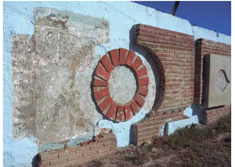
Una parte de la estructura se desplomó de súbito. /Fotos: Vicente Brito
