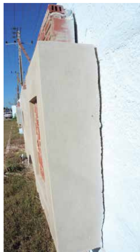
Algunos espirituanos advierten cómo la obra se ha ido despegando de la tapia.
