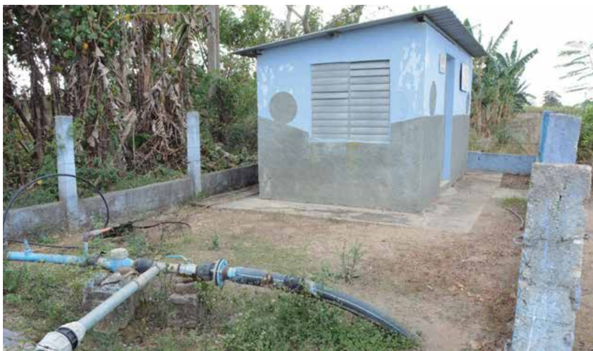
La experiencia se pondrá en práctica en el 46 por ciento de las estaciones de bombeo de la provincia. /Foto: Vicente Brito
