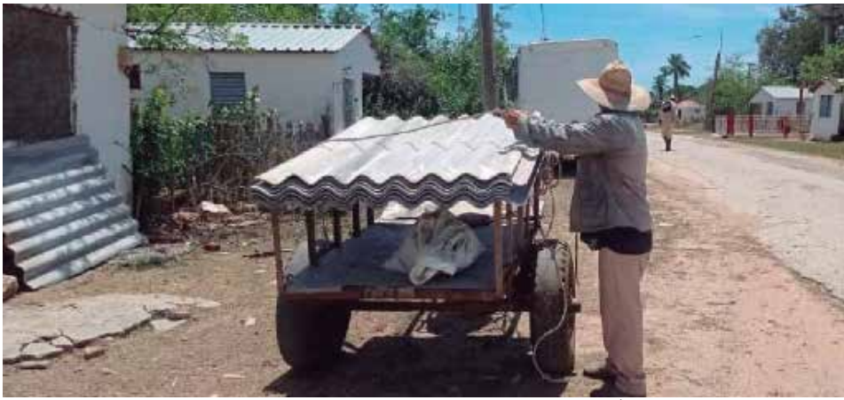
Con esfuerzo propio y la ayuda de los vecinos, avanza la recuperación de las viviendas dañadas.
