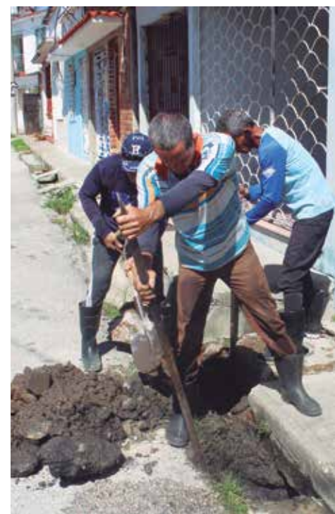
La desobstrucción de registros del alcantarillado figura entre las acciones. /Foto: José F. González
