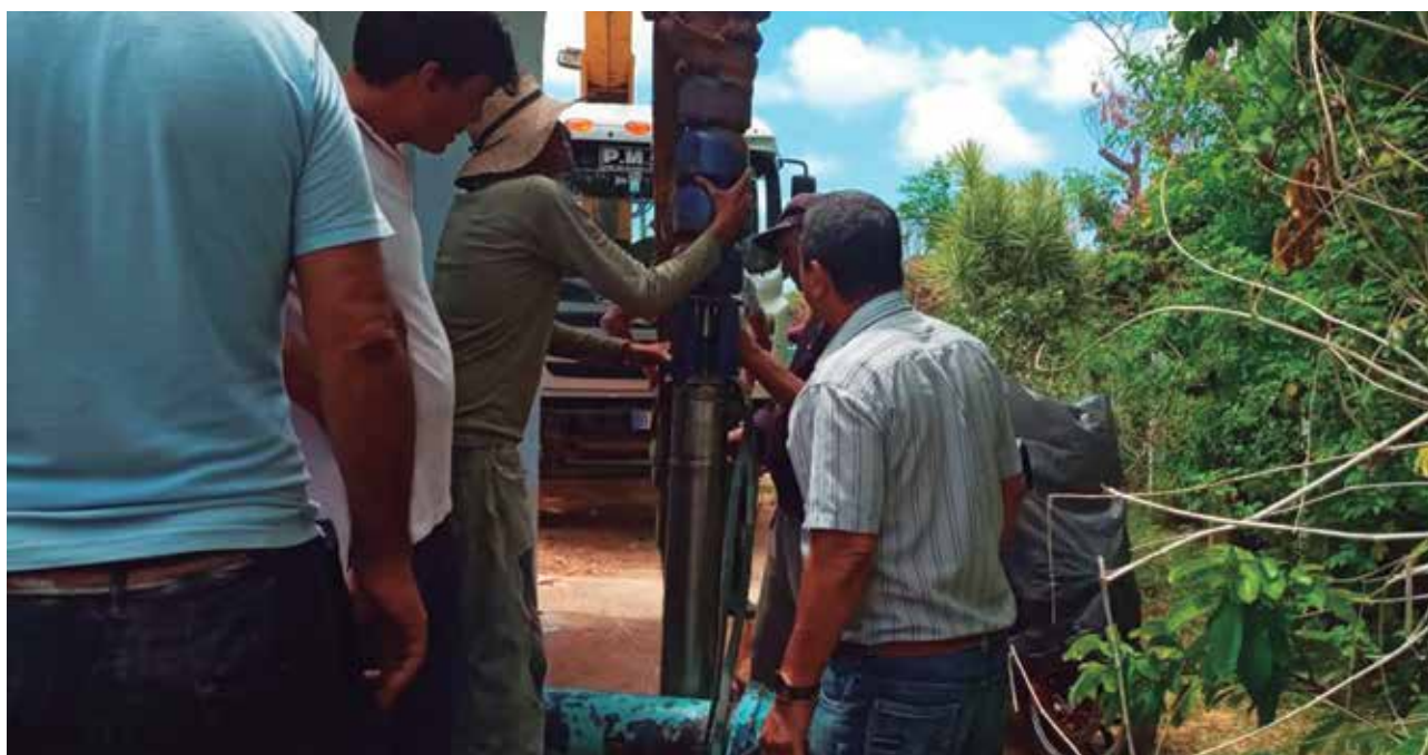
La reparación de equipos estabiliza de manera gradual el funcionamiento de las estaciones de bombeo en Trinidad. /Foto: Belkis Nieblas
