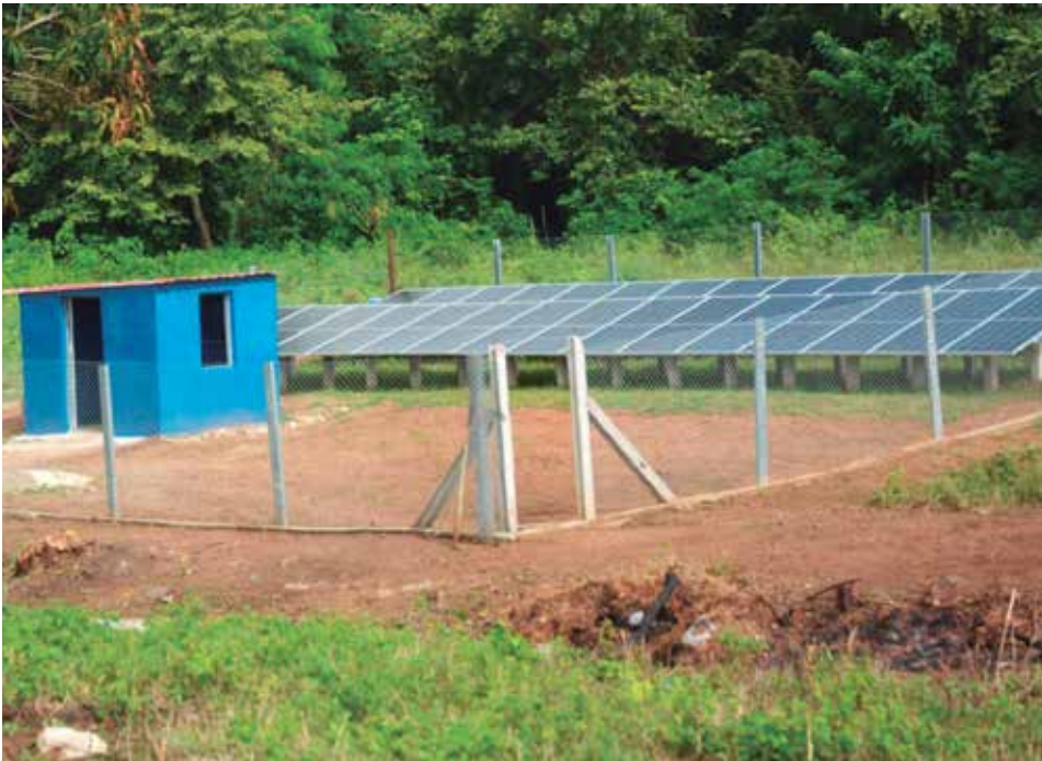
La estación de bombeo con matriz energética asegura el abasto de agua a la comunidad.
