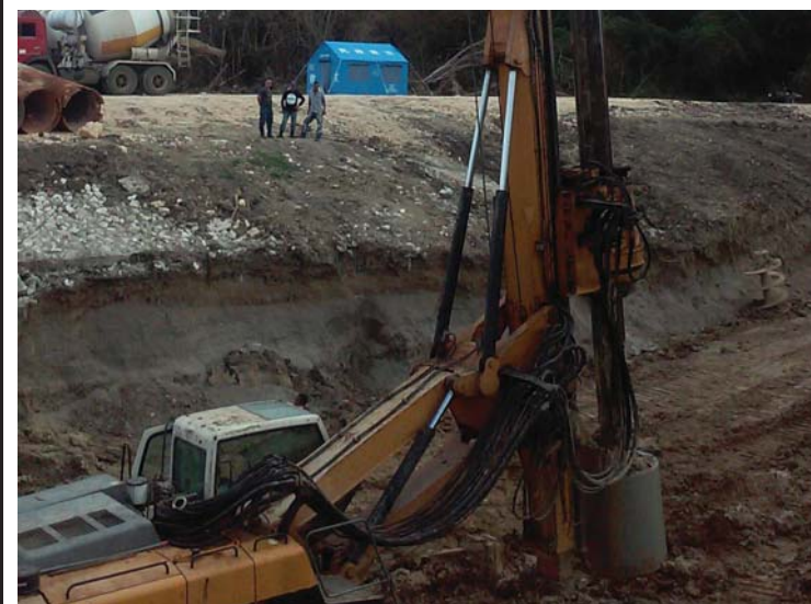
Este año los trabajos se concentraron en el aliviadero y el canal de salida, fundamentalmente. /Foto: Cortesía de Recursos Hidráulicos
