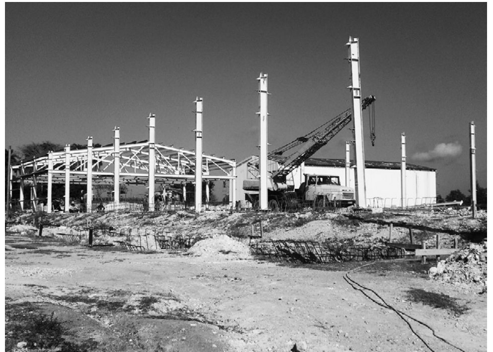
La falta de grúa para el izaje en algunas ocasiones ha limitado el avance de la obra.
