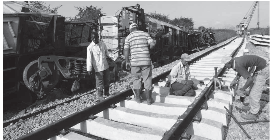
Como resultado del descarrilamiento fue preciso sustituir unos 120 metros de la vía.
