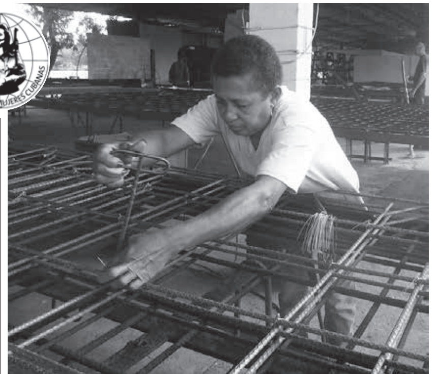
Las manos de Mayda unen las mallas para fundir paneles de hormigón.
