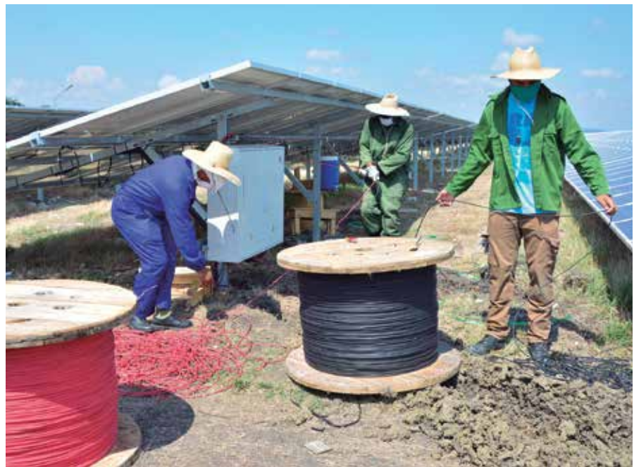
La extensión del parque solar fotovoltaico de Mayajigua tendrá una potencia instalada de 2.5 MW. /Foto: Vicente Brito
