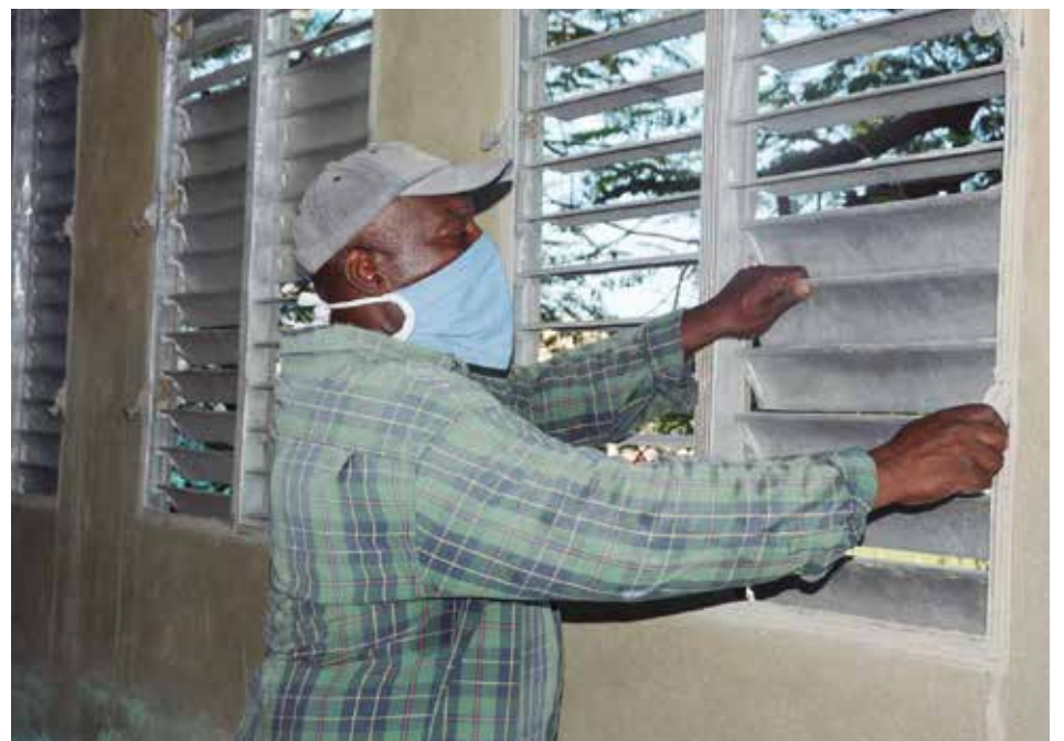
Brigadas constructoras del territorio emprenden varios objetos de obra para mejorar el confort de la instalación deportiva. /Foto: Vicente Brito
