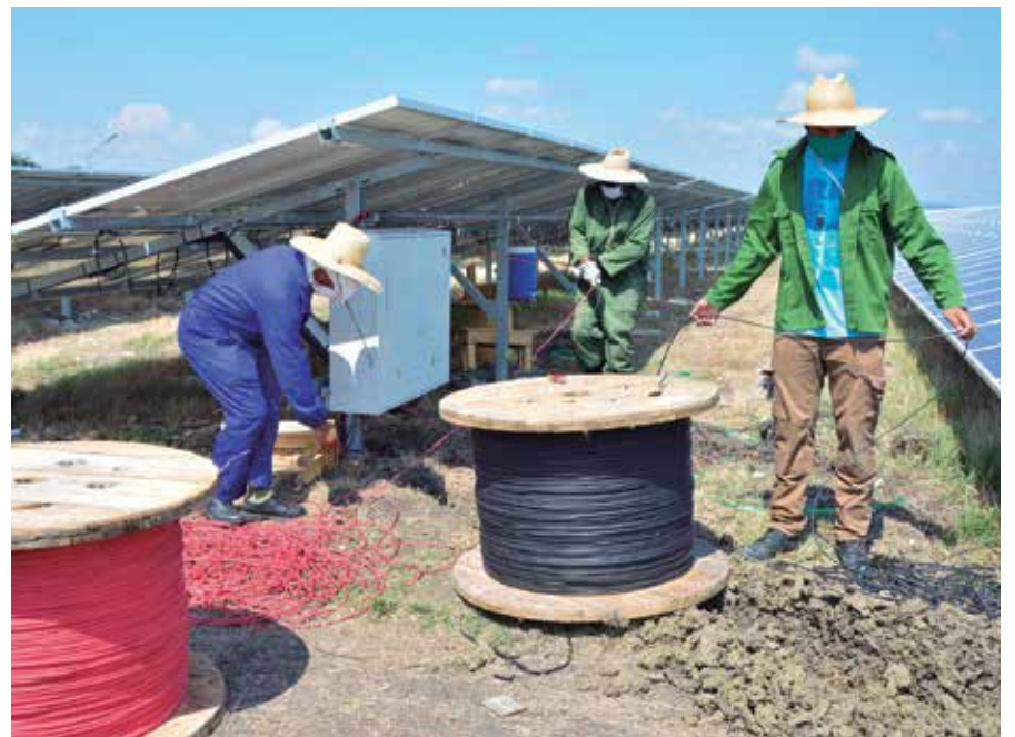
La extensión del parque solar fotovoltaico de Mayajigua tendrá una potencia instalada de 2.5 MW. /Foto: Vicente Brito
