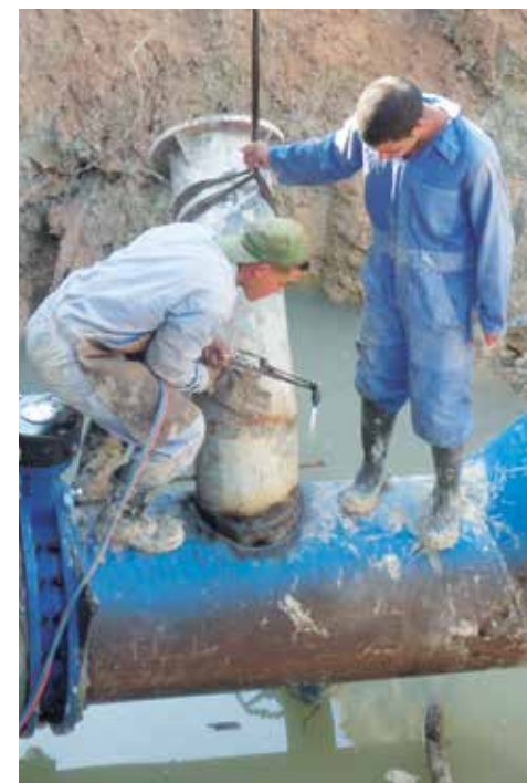
Unos 70 kilómetros de redes se han instalado para llevar el agua desde la presa Lebrije a los pobladores de Jatibonico. /Foto: Luis Herrera
