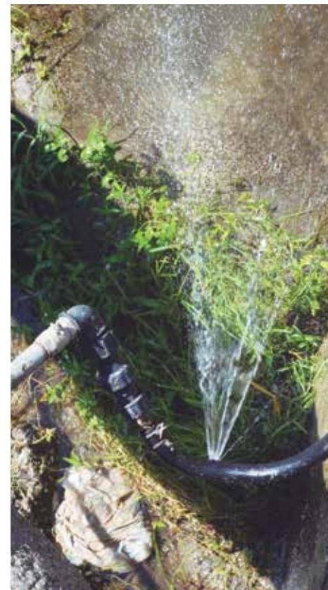
Tan fácil de reparar que parece y este salidero en una conductora cercana al Combinado Lácteo lleva años vertiendo constantemente.
