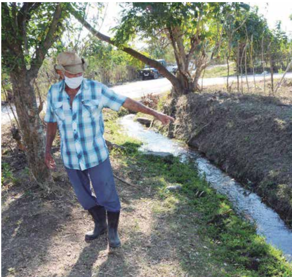
Hace más de un año que por esta zanja corre agua potable de un salidero que afecta la entrada del líquido a dos industrias productoras de materiales de la construcción.
