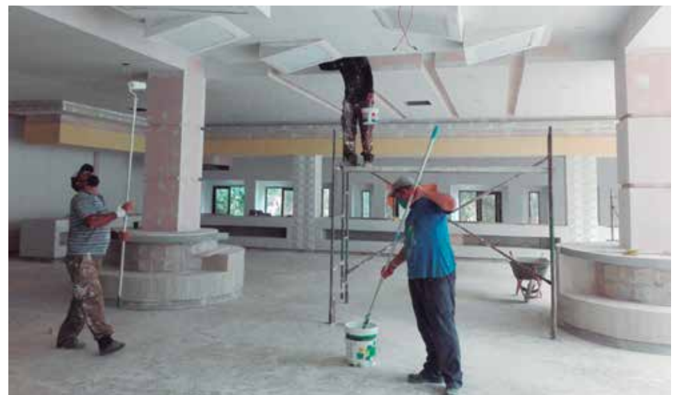
En el hotel Club Amigo Ancón se ha renovado completamente la imagen del lobby y el restaurante principal.
