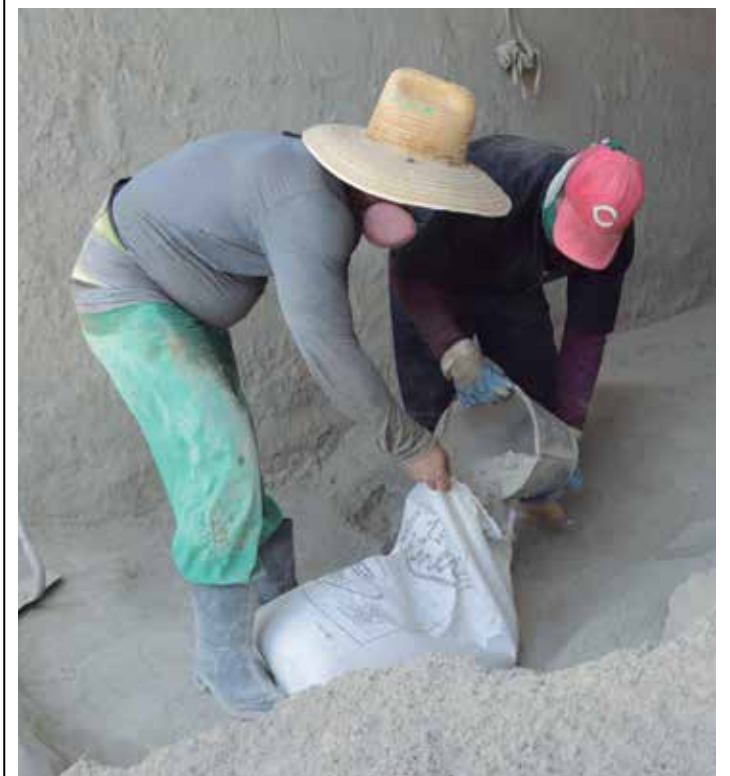
Uno de los puntos débiles en la construcción de viviendas es la ausencia de recursos vitales en las tiendas de materiales. /Foto: Vicente Brito
