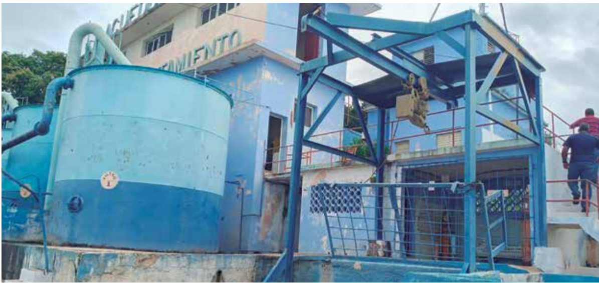
En la Planta Potabilizadora el agua que llega desde San Juan de Letrán recibe tratamiento y se filtra para su distribución
