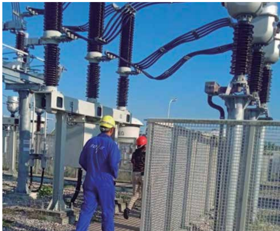
La subestación de 220 kilovoltios, ubicada en Tuinucú, sincronizó con el SEN hace cerca de una década. Foto: Cortesía de la ECIE
