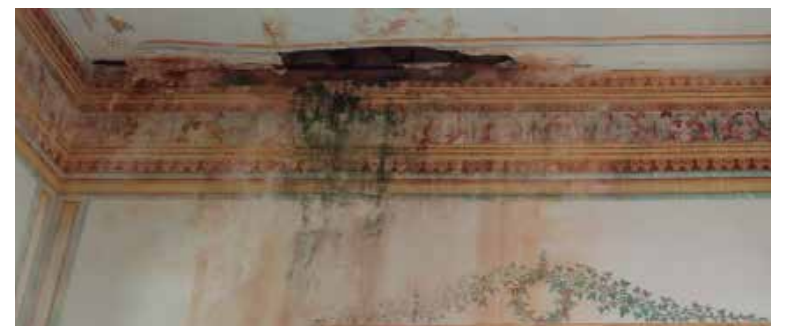
Una de las salas del Museo Municipal de Historia fue cerrada por peligro de derrumbe de su falso techo.
