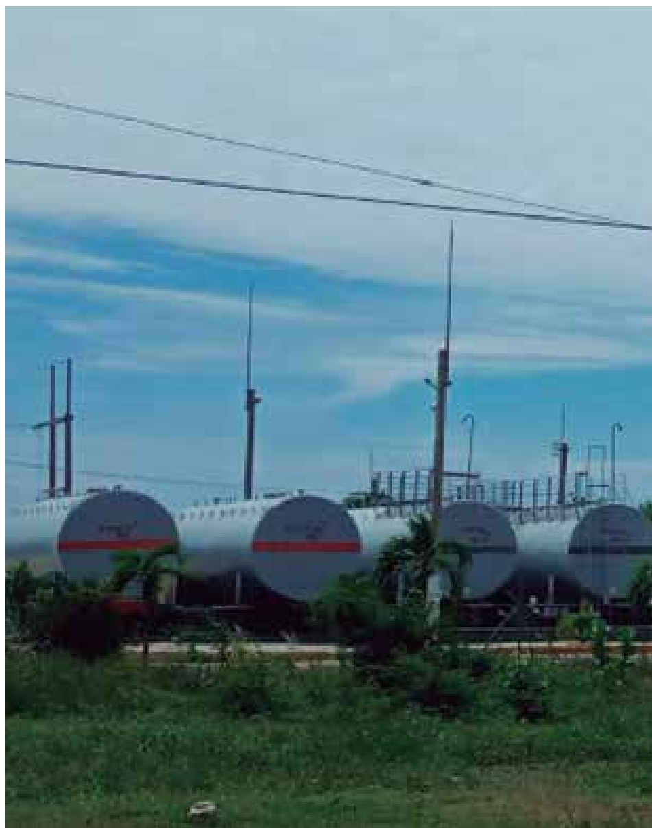
La central diésel de Trinidad aporta 7.1 megawatts al Sistema Eléctrico Nacional.
