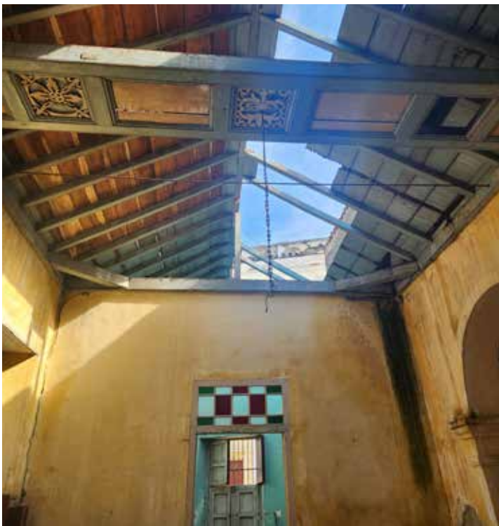
El estado constructivo de la vivienda era deplorable.
