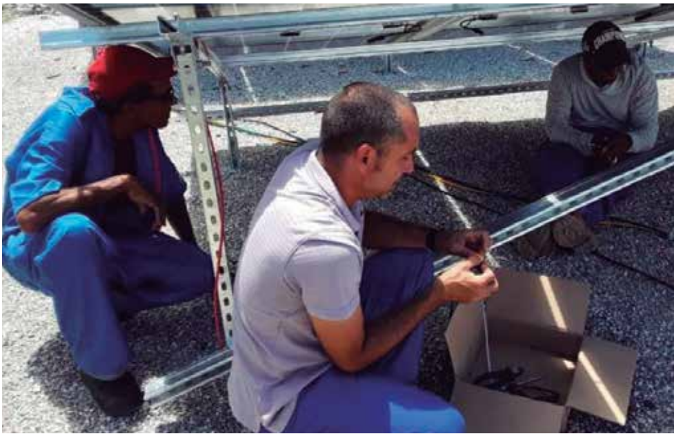
Los propios trabajadores de RadioCuba ejecutaron la instalación. /Foto: Cortesía de la empresa
