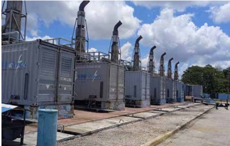
La generación distribuida con motores diésel es fundamental para garantizar el servicio eléctrico ante una desconexión total del SEN.
