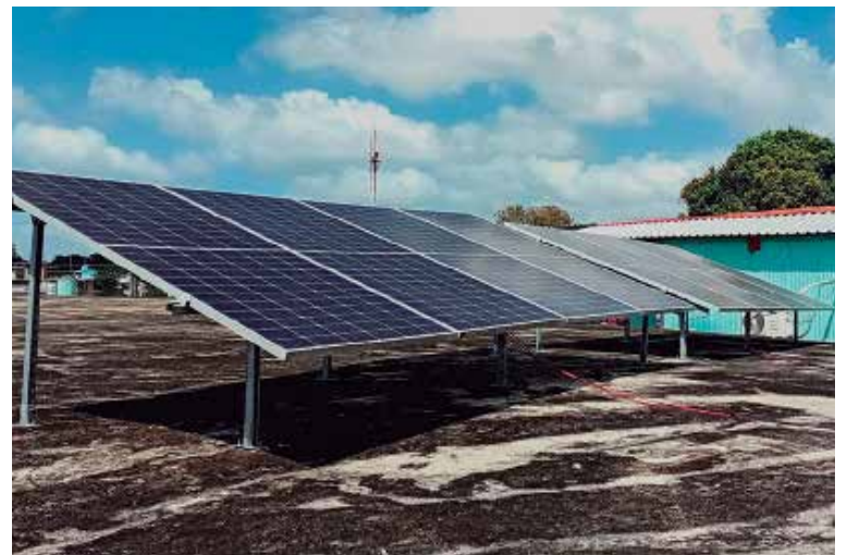
La Empresa de Tabaco Torcido Sancti Spíritus cuenta con más de 90 kilowatts de energía fotovoltaica instalada en sus unidades.
