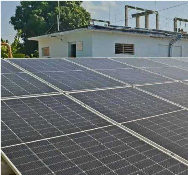
El sistema de energía solar garantiza la independencia por casi 10 horas de la estación de bombeo ubicada en la carretera de Trinidad a La Boca.
